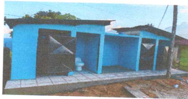
Foto 4: SERVICIO SANITARIO Y SUS ACCESORIOS
